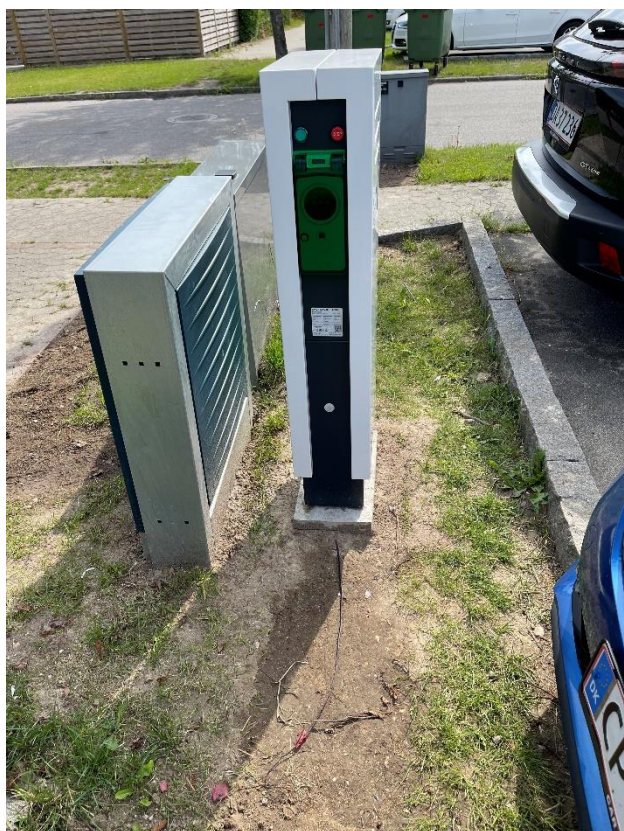
Ladestander ved Glentehusene i Albertslund.
