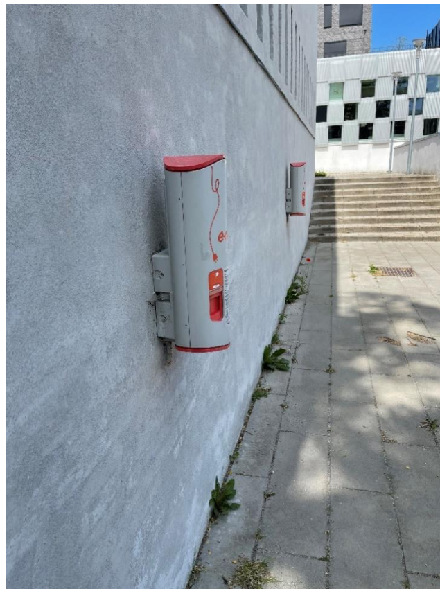
Ladestander ved Gate 21 i Albertslund Kommune.
